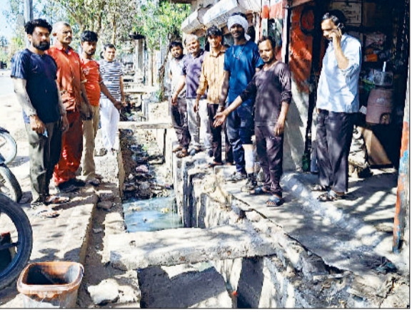
झज्जर । खुले नाले के साथ खड़े दुकानदार व नाला में गिरा हुआ पत्थर ।
